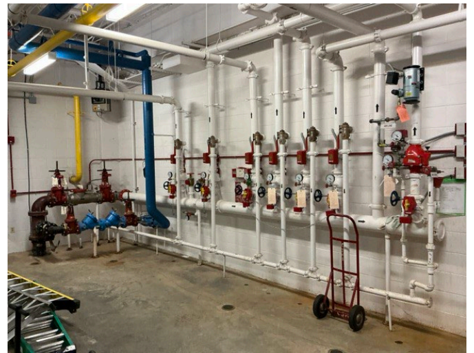
34 - FIRE SPRINKLER RISERS
